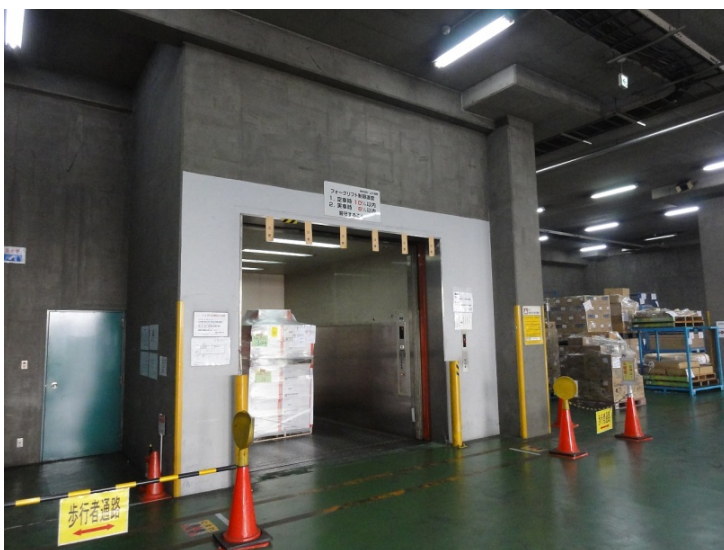
(Es una medida de prevención para evitar choque entre montacargas que sale del ascensor y transeúntes.)
